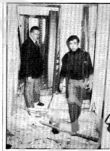
ROMA — L'ingresso dello studio privato del ministro Cossiga devastato dalla bomba.
